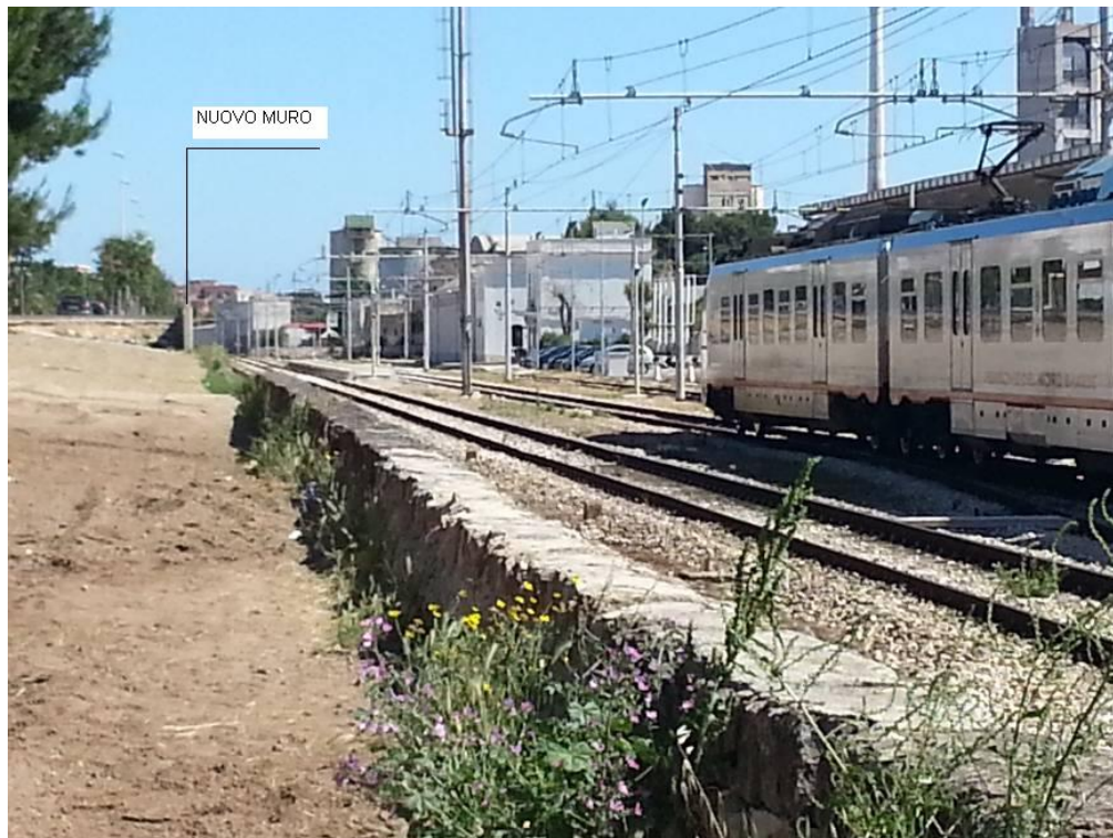
Condomino posto a nord dell'area di interesse – nuovo muro di contenimento del terreno di riporto e di confine RFI.
