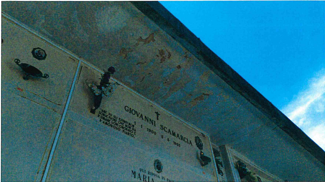
Intradossi ammalorati lastrici solari Sezione 10
