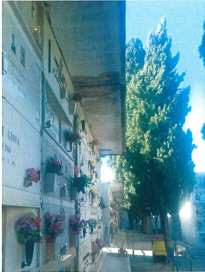
Intradossi ammalorati dei lastrici solari Sezione 5
