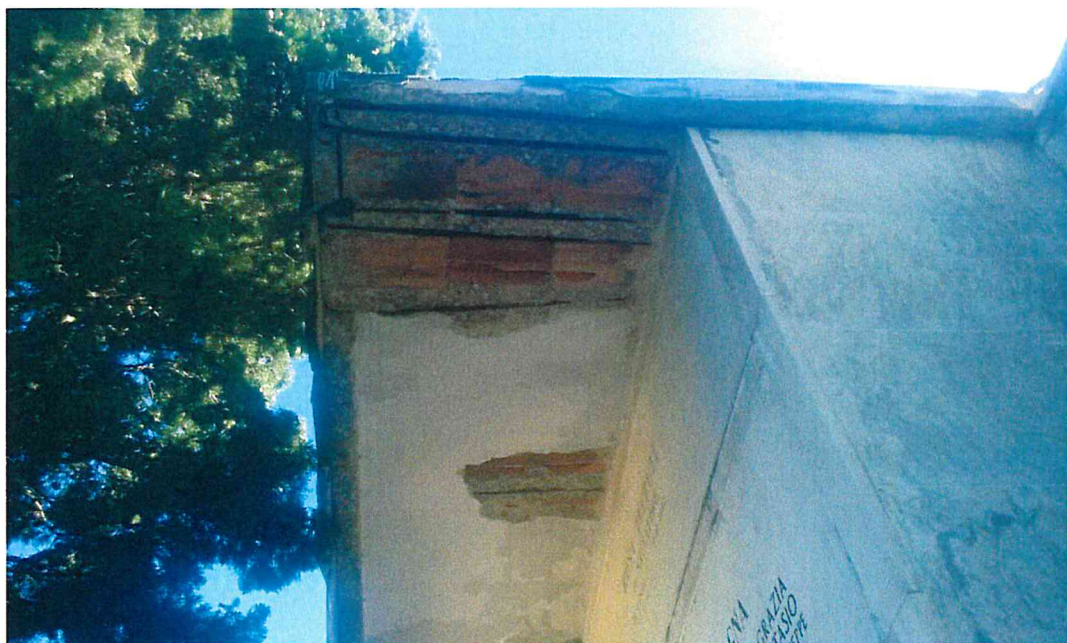
Particolare dei distacchi in c.a. lastrico solare Sezione 5
