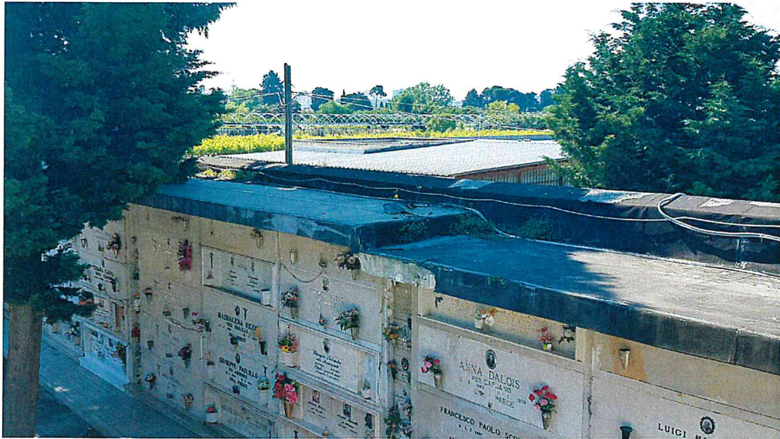
Guaina ammalorata e particolare del distacco frontalino in c.a Sezione 7
