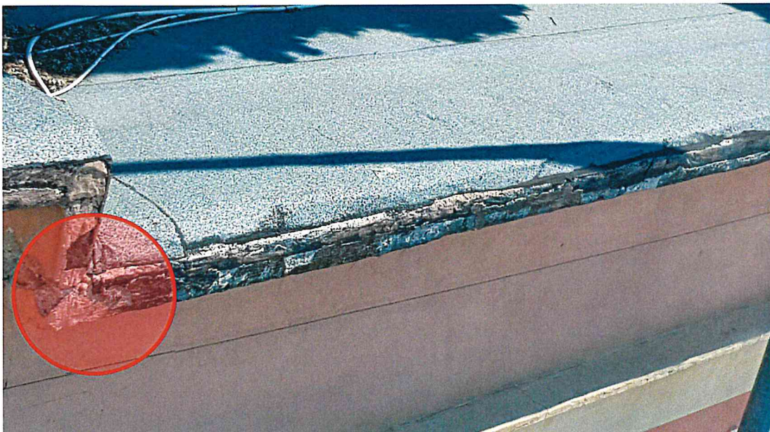
Particolare dei frontolini in c.a. ammalorati dei lastrici solari di cui alla Sezione 5
