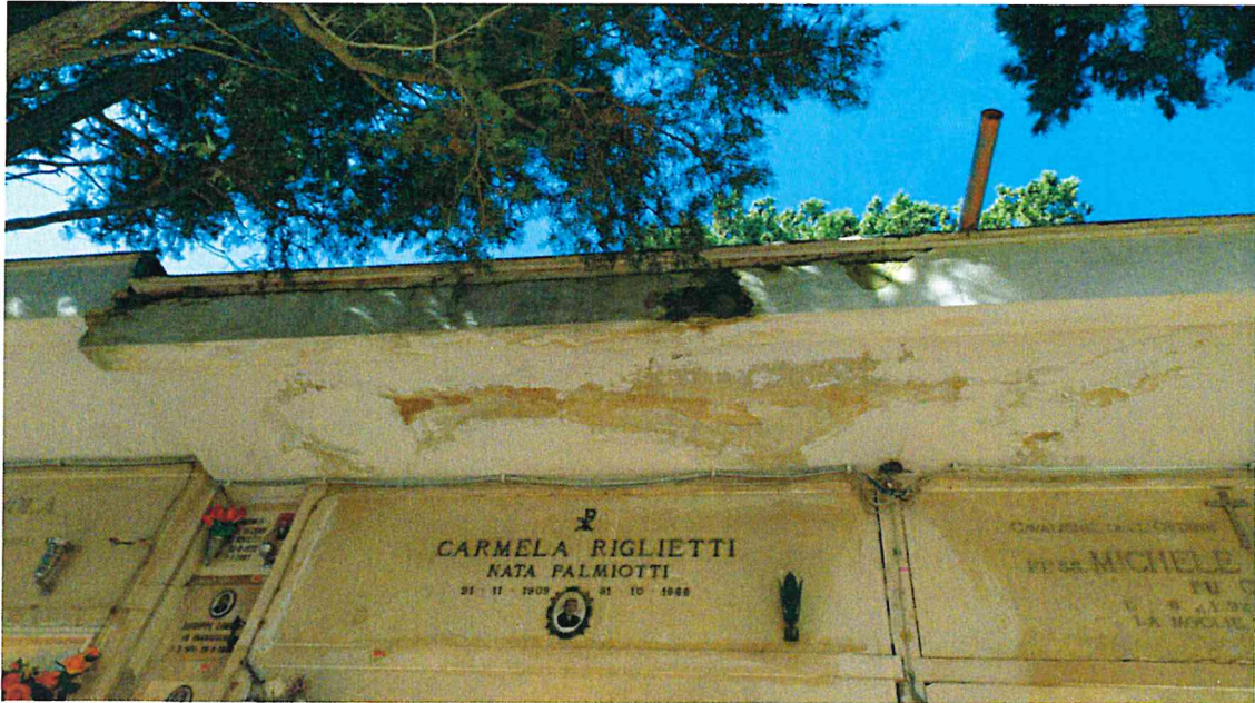
Distacchi intonaco intradosso lastrico solare Sezione 10
