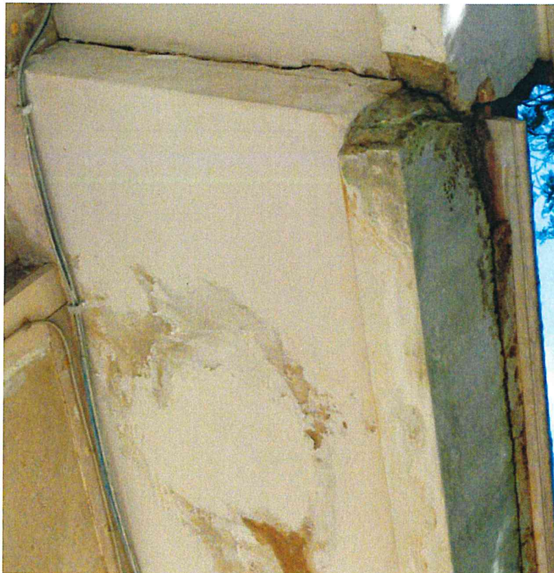
Particolare distacchi intonaco intradosso lastrico solare Sezione 10
