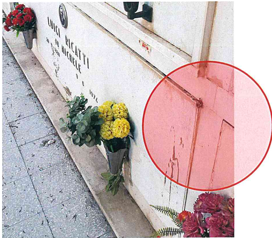
Particolare lastra in pietra distaccata Sezione 10
