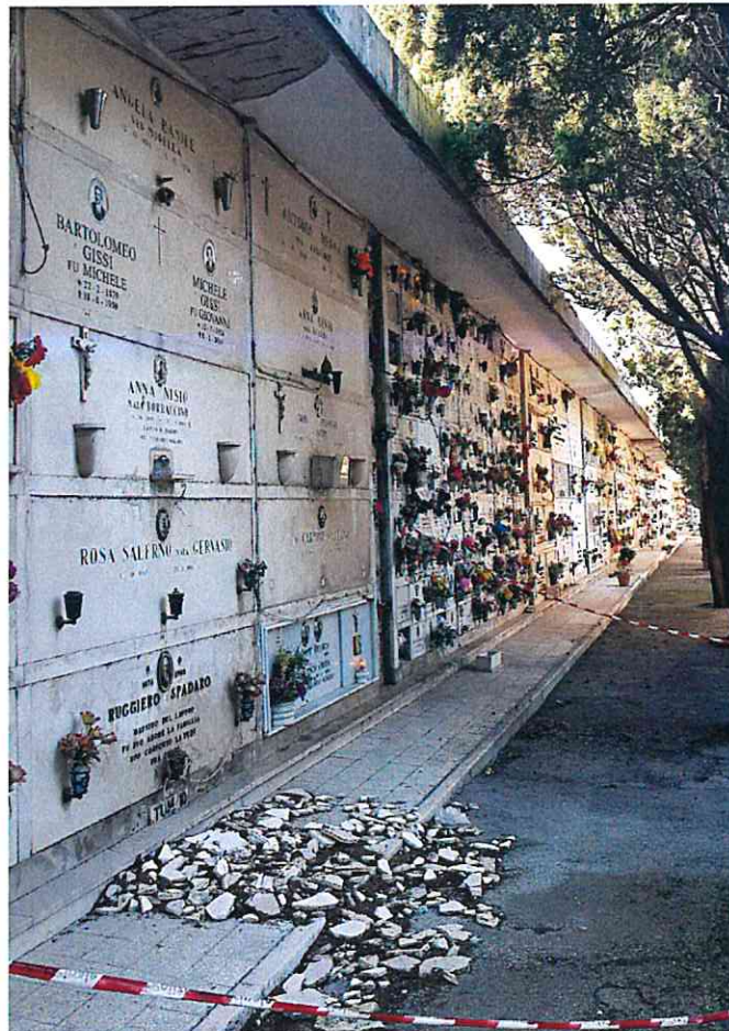
Parte di Intonaco Distaccato area interdetta Sezione 5
