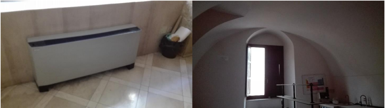
Figura 5: Pavimenti e soffitti
