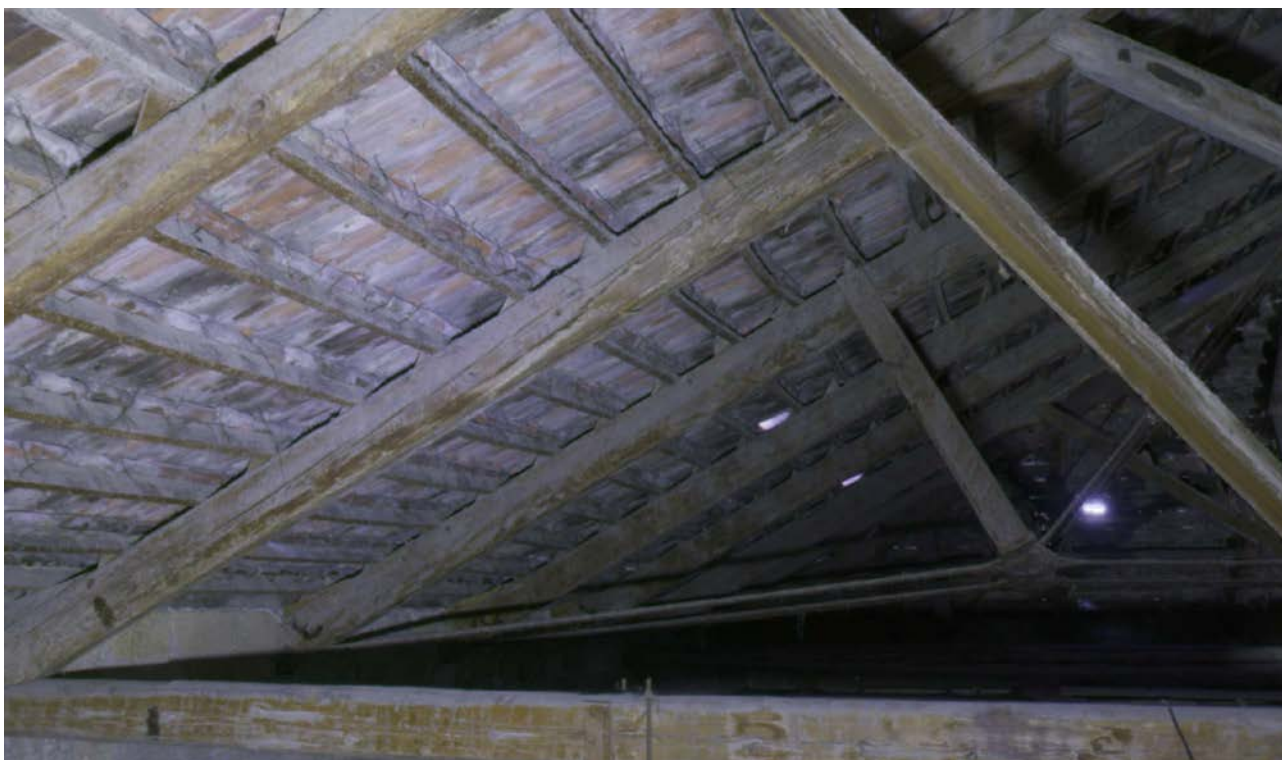
FOTO D- Stato del sottotetto
