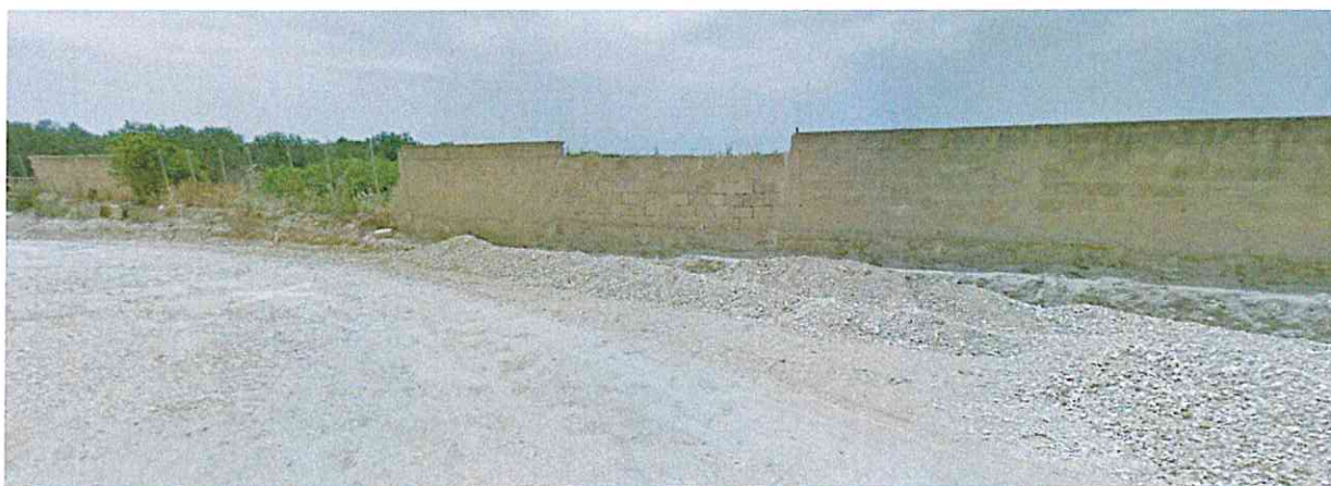
Recinzione in tufo demolita in quanto per lo scavo effettuato risultava pericolosa.
