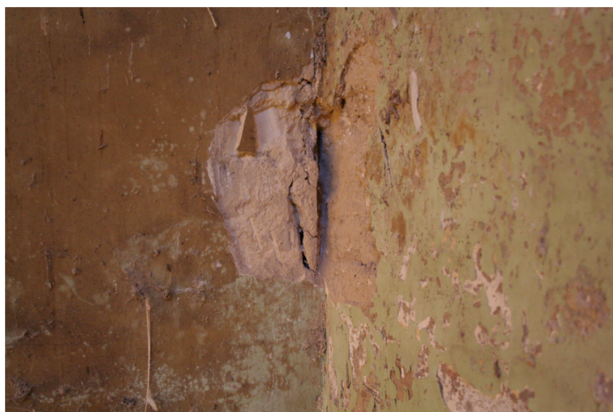
Esempio di mancata ammorsatura dei setti murari
