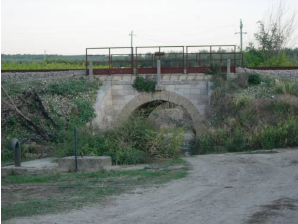
Strada dalla Salinelle al lago San mercurio – il sottopasso ferroviario
