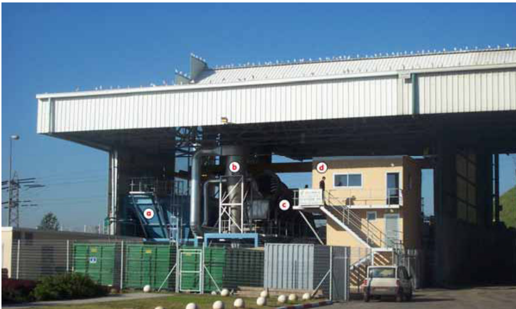
Figura 2. Ingresso visitatori al sottosistema di separazione/preparazione dell'impianto (i cassoni in primo piano sono rimasti dalla costruzione del sito).
