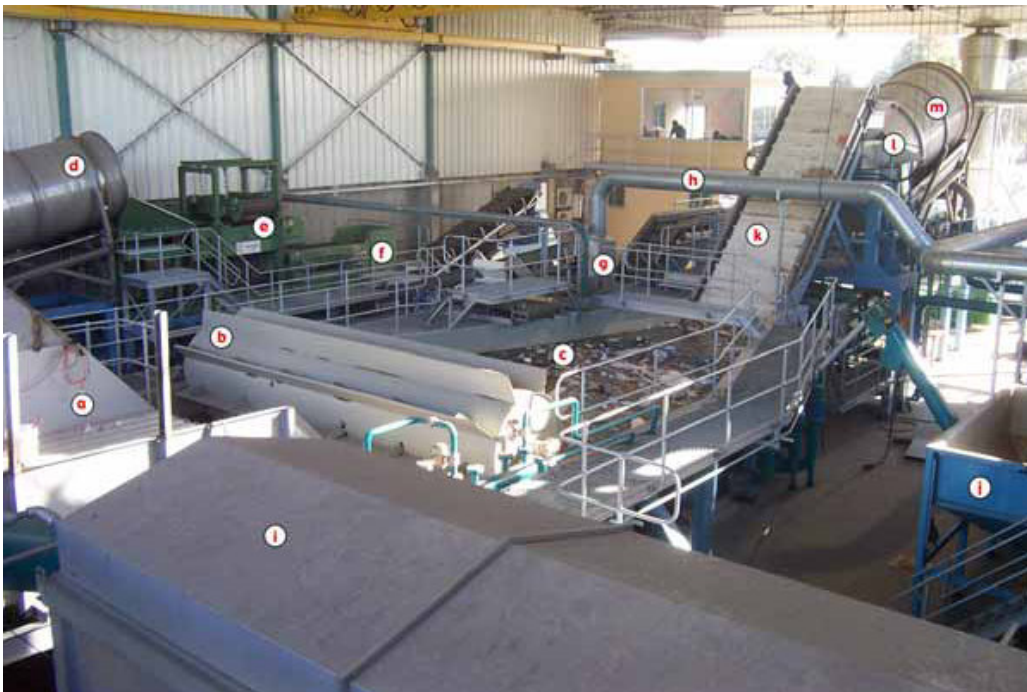
Figura 4. Interno del sottosistema meccanico di separazione/preparazione, visto attraverso l'ingresso visitatori (si veda figura 2 per orientarsi). La piattaforma di scarico è posta alle spalle del fotografo. Per avere un'idea delle dimensioni, la ringhiera arriva all'altezza della vita. (Foto scattata nelle fasi iniziali di test dell'impianto)
